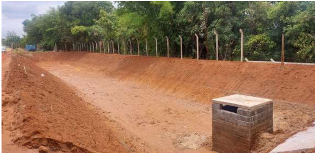
Bacia de contenção e monge
