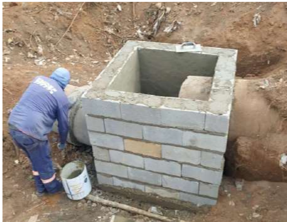
Poço de visita
